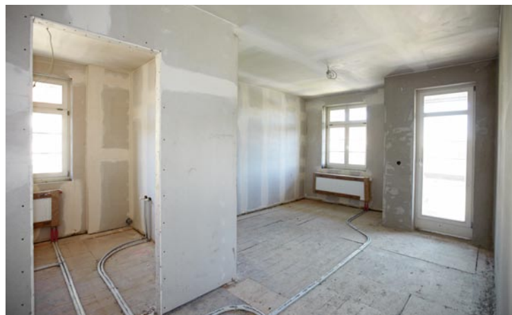
Innendämmungen werden zur Vermeidung von Wärmebrücken vom Rohfußboden bis zur Decke lückenlos verlegt
