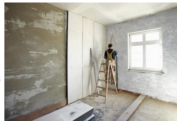
Die saubere und von Rissen bzw. Unebenheiten befreite Wand wird mit Grundierung vorbereitet
